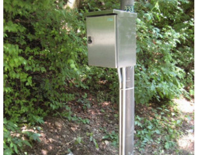
Standort Residenzstraße, München Sensoren im eigenen Betonfundament
