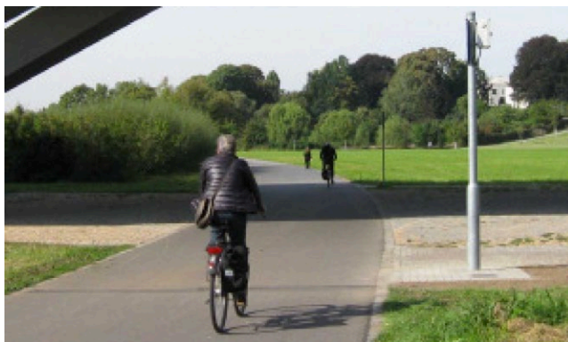
Standort Elbradweg, Dresden, Schaltschrank hochgesetzt zum Schutz gegen Hochwasser
