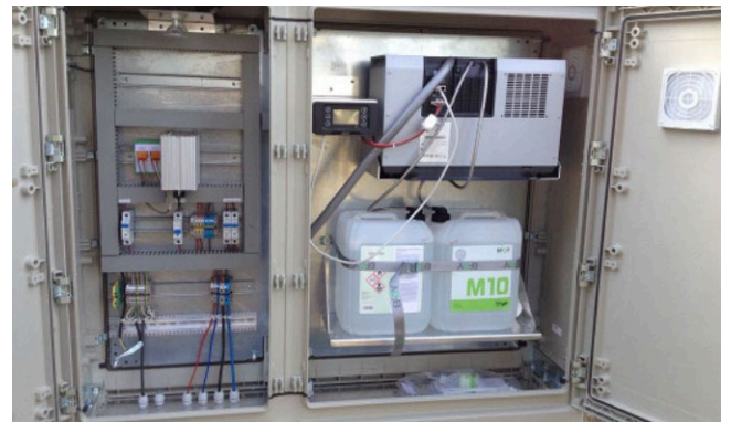
Standort Versorgung über Methanol-Brennstoffzelle Österreich L48 Bödelestr
